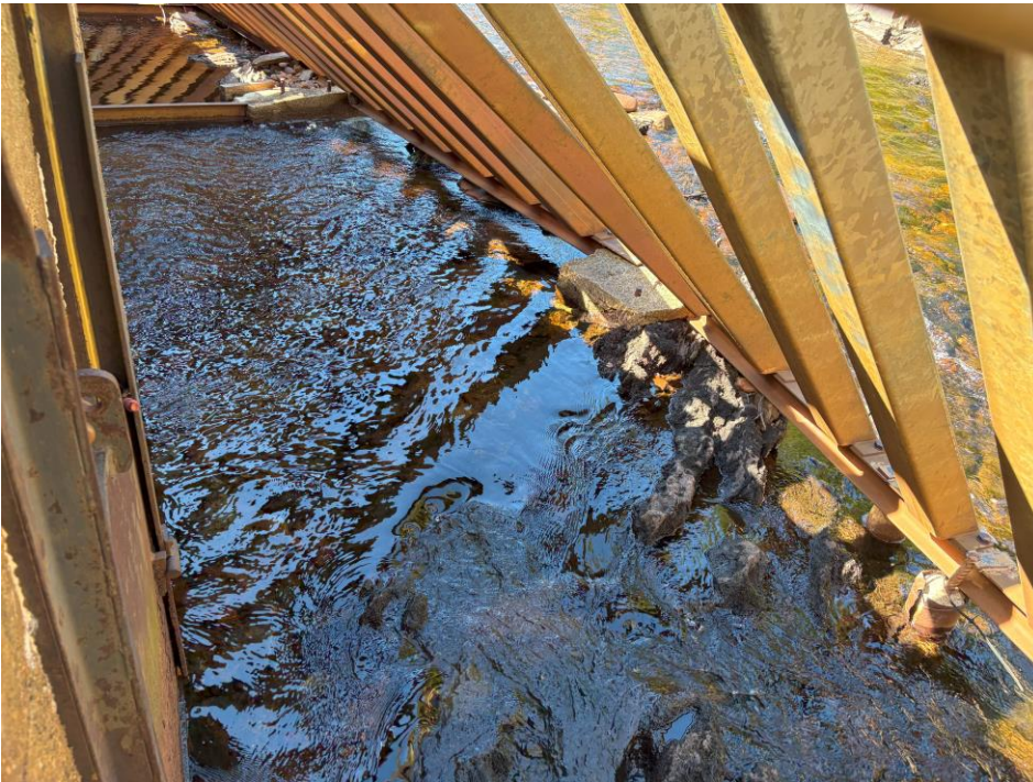
Bilde 13 På innside av isrist, oppstrøms side av inntaksdam
