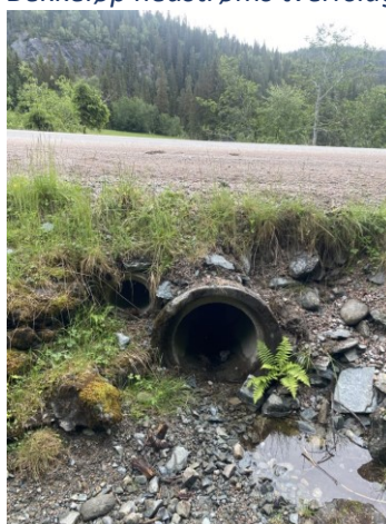
Stikkrenne under fylkesvegen. Her merkes nivået for 100 l/s.
