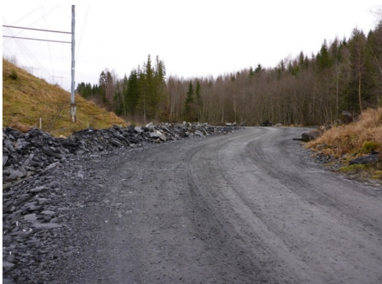
Figur 7-1 Hofstadelva etter utkjøring av steinmasser. Midlertidig løp ved siden av anleggsveien. Bildet er fra desember 2014
