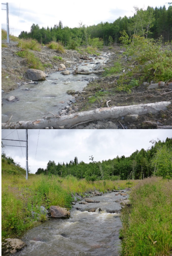
Figur 7-2: Hofstadelva samme sted etter endt sikringsarbeid. Bildene er tatt henholdsvis i 2015 og 2017
