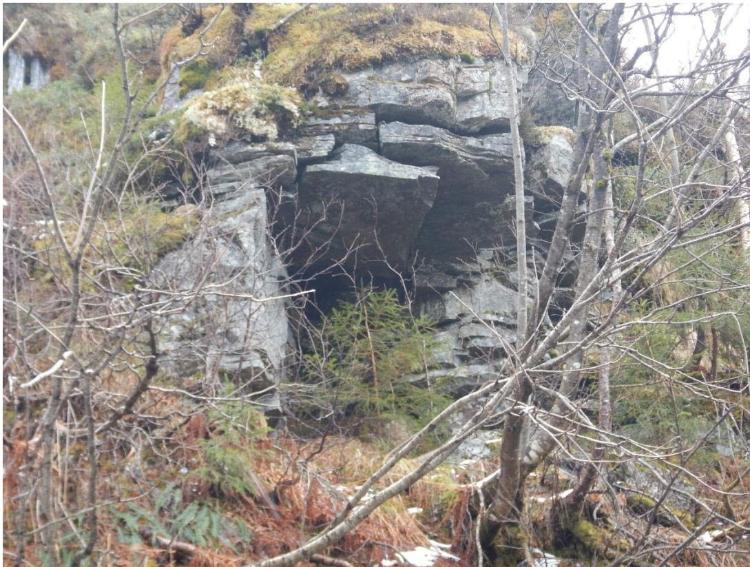
Figur 6: Eksempel på en oppsprukken del av bergskrent i påvirkningsområdet. Bildet er tatt mot øst.
