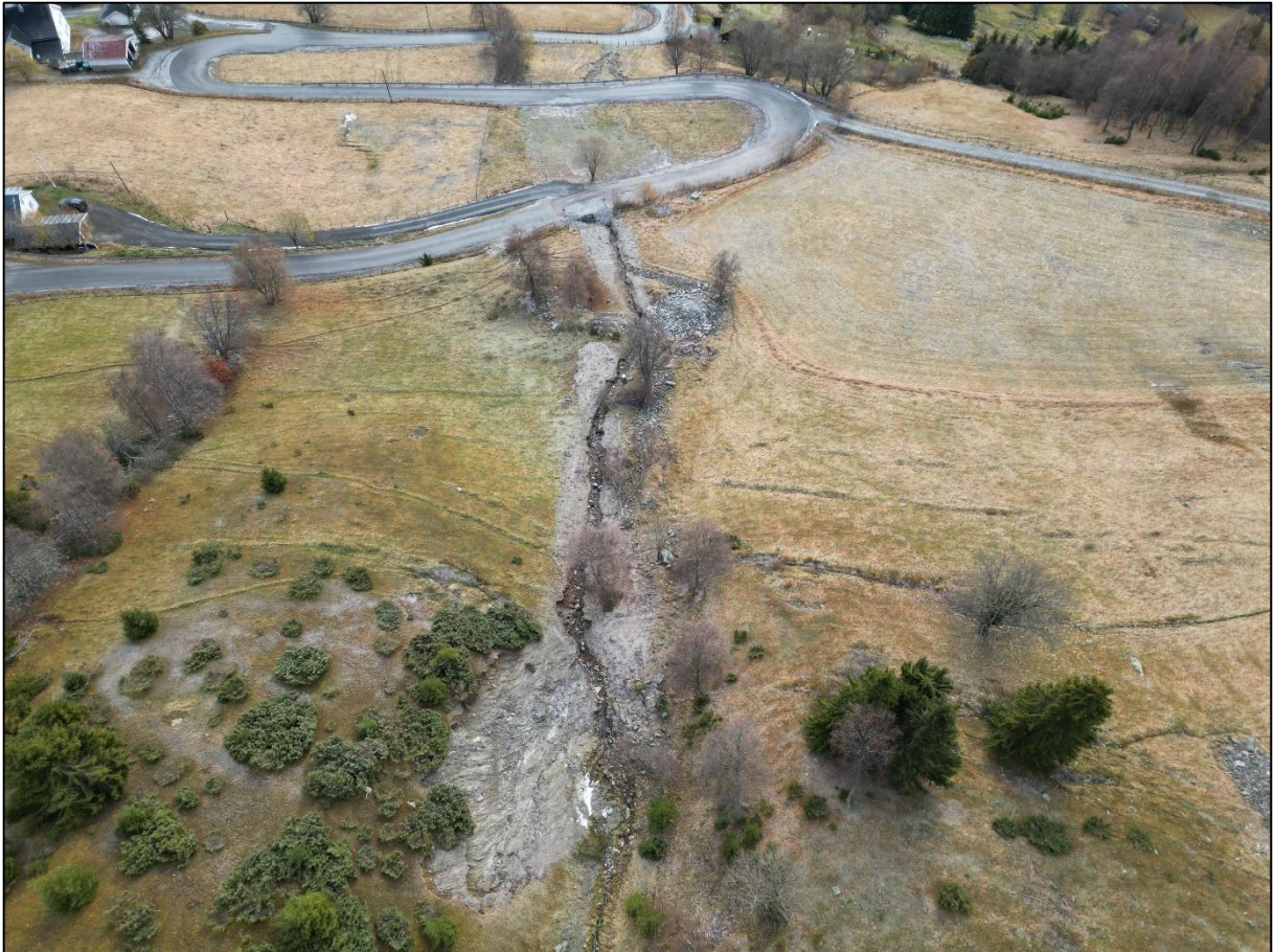
Figur 2: Bildet skredet ved Råan (ID20) sett ovenfra. Bildet er tatt sørover, med drone.
