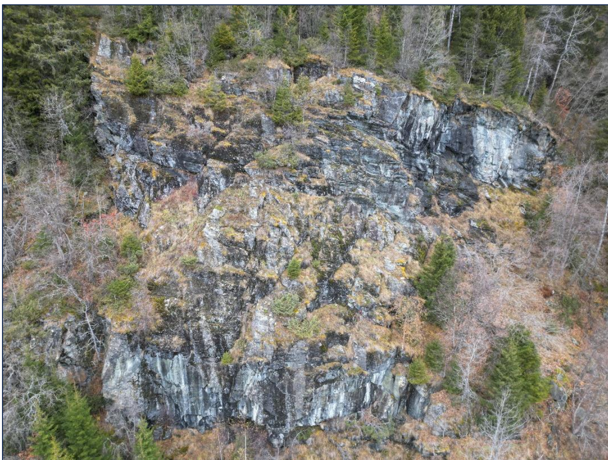
Figur 7: Bildet viser løsneområder for steinsprang ved Tunebekken. Bildet er tatt mot nord, ved hjelp av drone på befaring.
