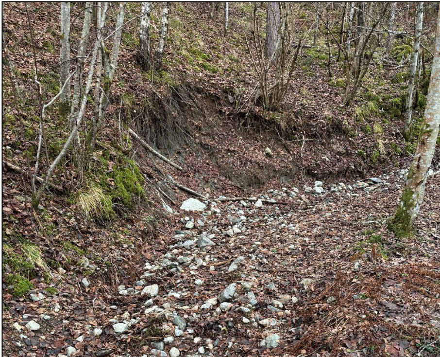
Figur 8: Mindre utglidning/erosjon langs med skogsbilveg. Det var tydelige tegn til at bekkeløp hadde fulgt vegen, og erosjon av masser i yttersving resulterte i en mindre utglidning i finere løsmasser. Bildet er tatt ca. 50 moh.
