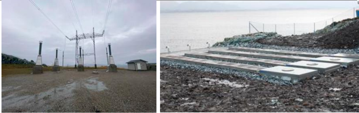
Figur 3: Dagens muffeanlegg (til venstre) og kulverter for strekkavlastning (til høyre) på Mongstad. Kilde: Statnetts konsesjonssøknad.
