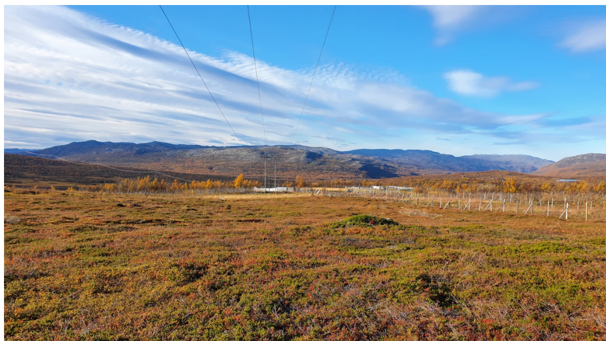
Figur 16: Foto av 66 kV traseen med gjerdeanlegg for rein like nordøst for Skaidi transformatorstasjon
