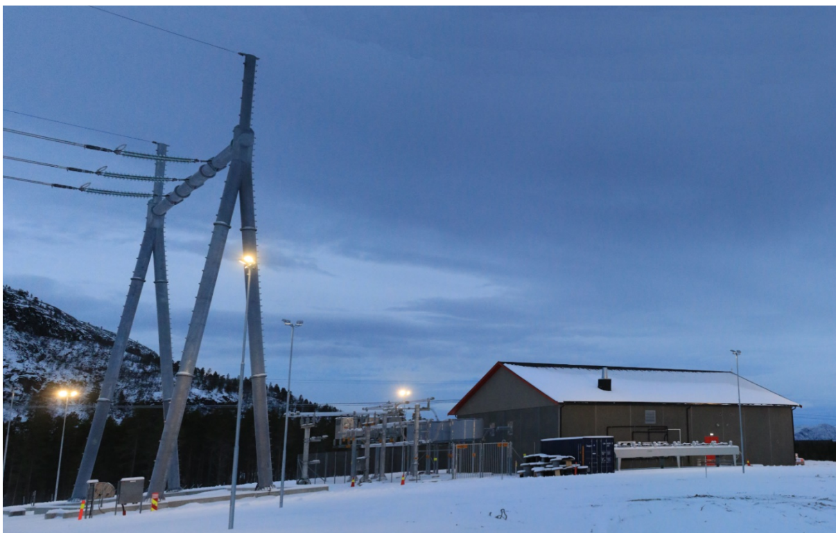
Figur 26: Bildet er et eksempel på et kompenseringsanlegg med transformator til venstre, apparatanlegg og i bakgrunnen ses SVS-bygget.
