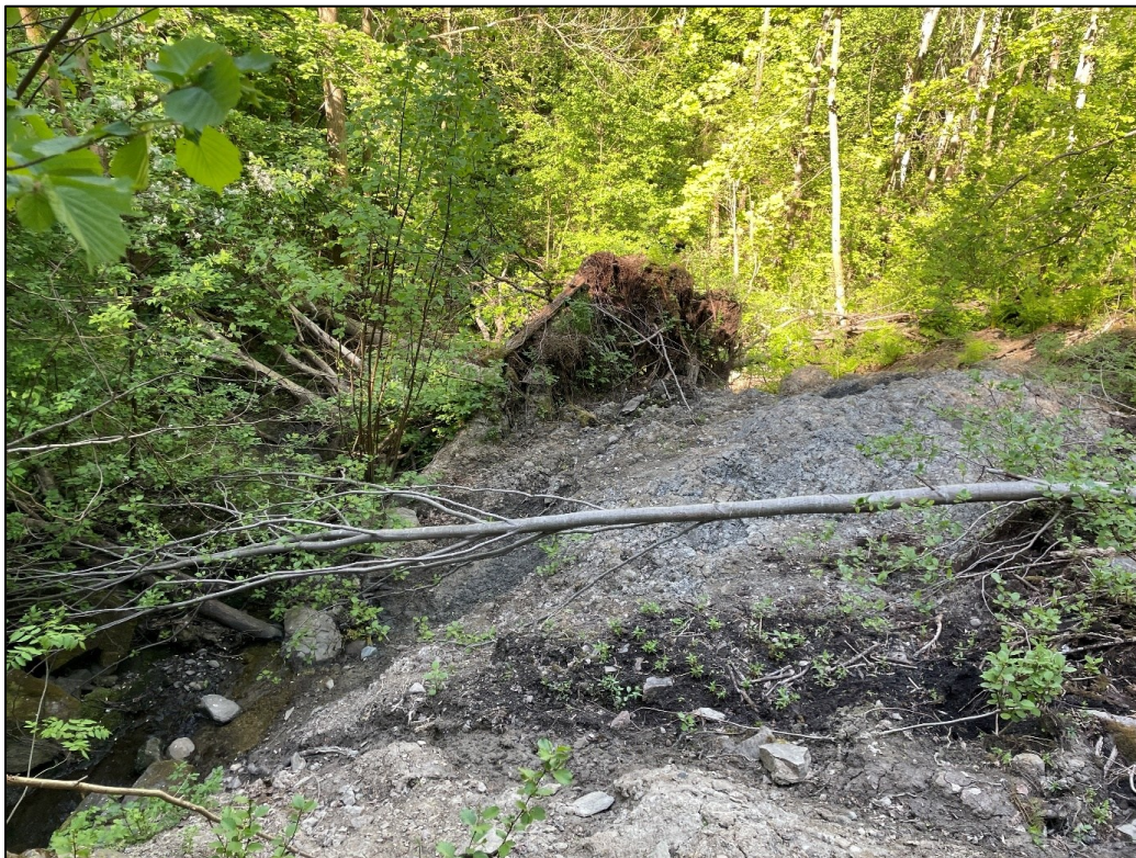
Figur 16: Utglidning i løsmassedekket bestående av leire sør i påvirkningsområdet.
