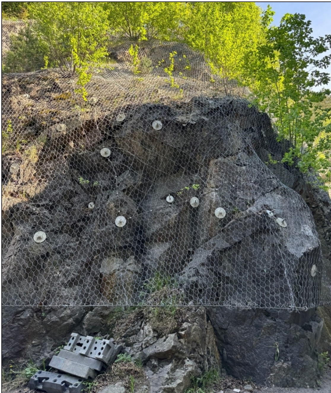
Figur 11: Hjørne på bergskjæring ved utkjøring fra "Drive In", som er sikret med vaiernett. En kan tydelig se sprekkesettene som gir mulighet for kileutglidning av større berglegemer.
