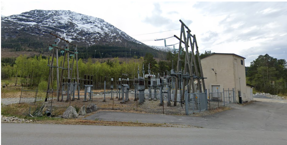
Figur 2-7: Eksisterende Bu transformatorstasjon sett fra øst.
