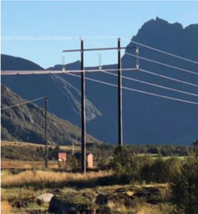
Figur 4-7 132 kV mast i tre
