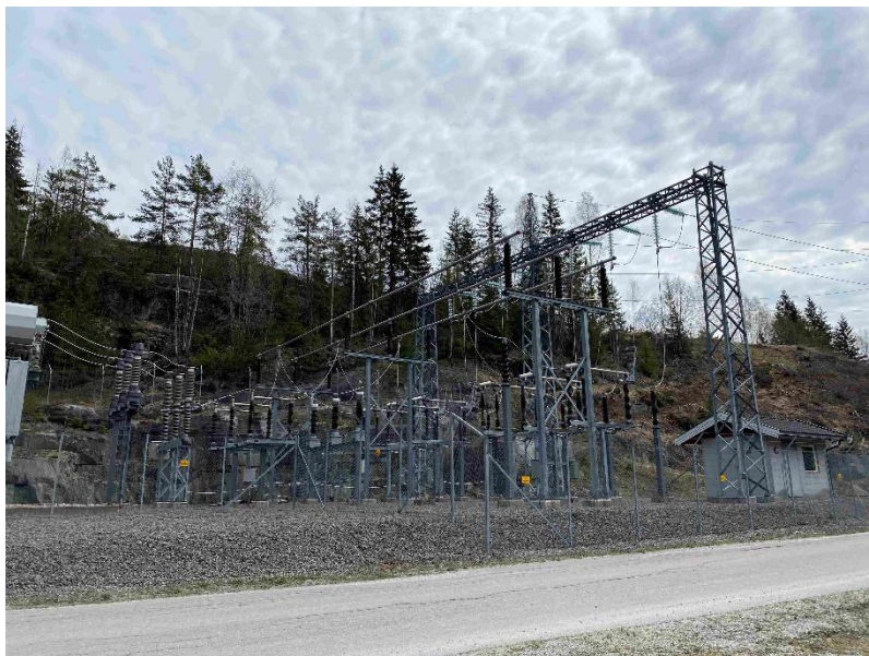
Figur 10 Eksisterende Kaggefoss transformatorstasjon langs Kaggefossveien skal utvides noe mellom eksisterende stasjonsområde og Kaggefossveien i forkant på bildet.
