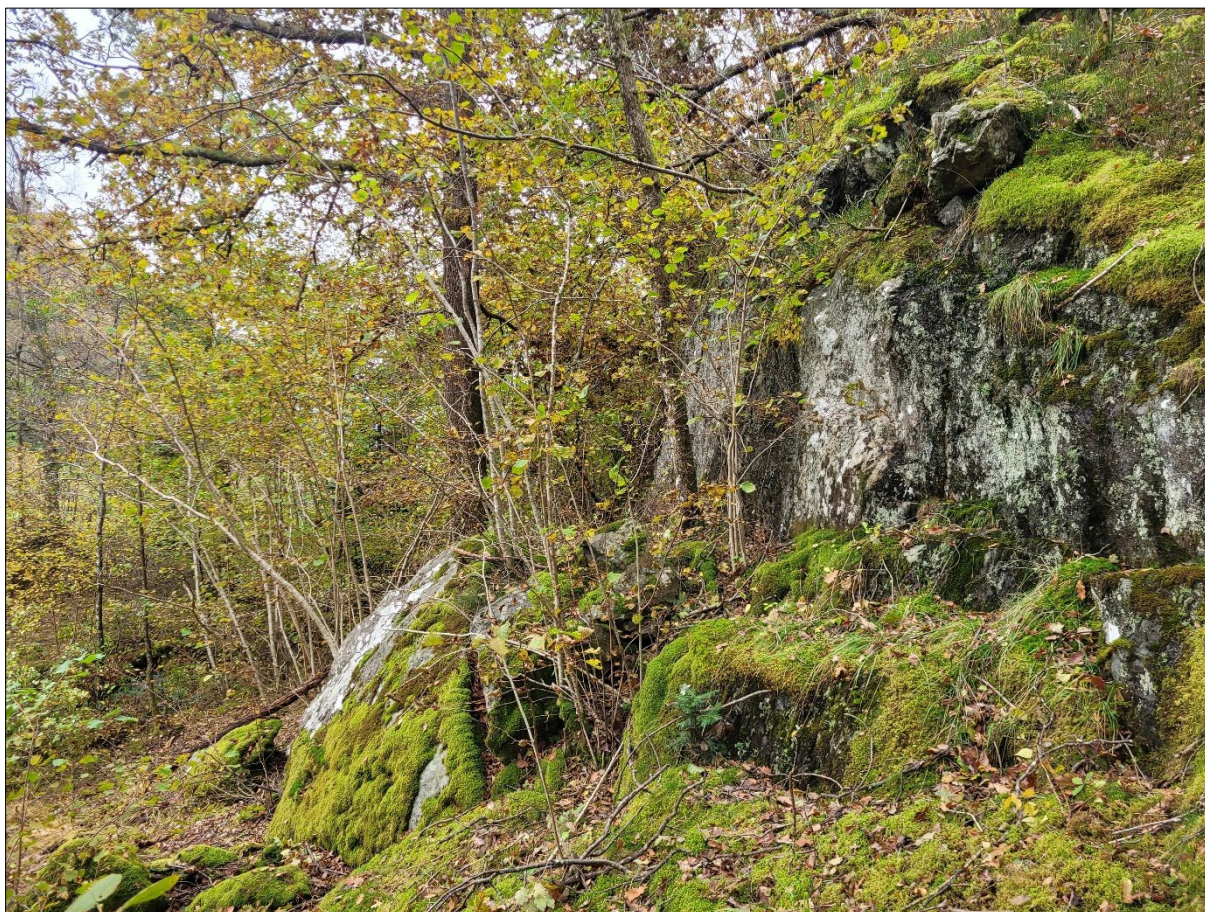
Figur 6: Kring 2 m høg fjellskrent nordvest i kartleggingsområdet. Vurdert til å ikkje ha potensiale for steinsprang med skadepotensiale.
