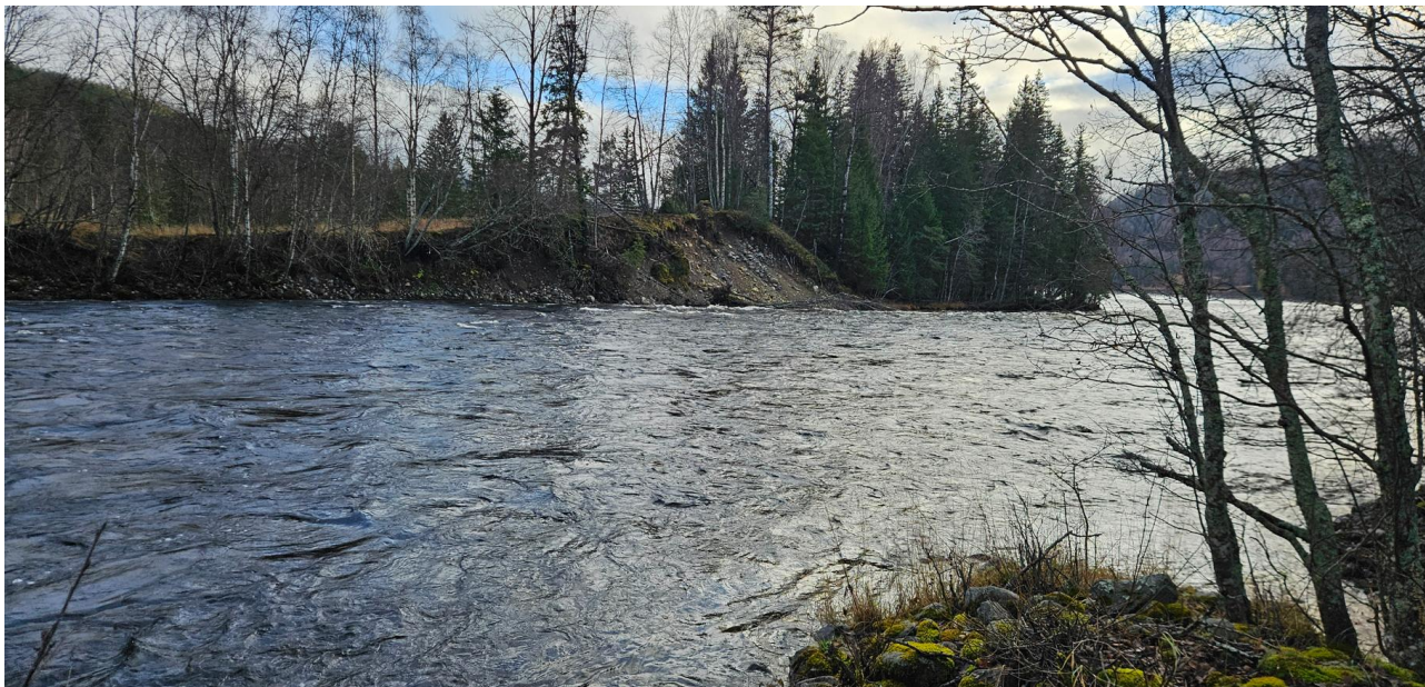
Figur 6 Pågående erosjon i skrent i stryken ned mot Kravikfjorden.
