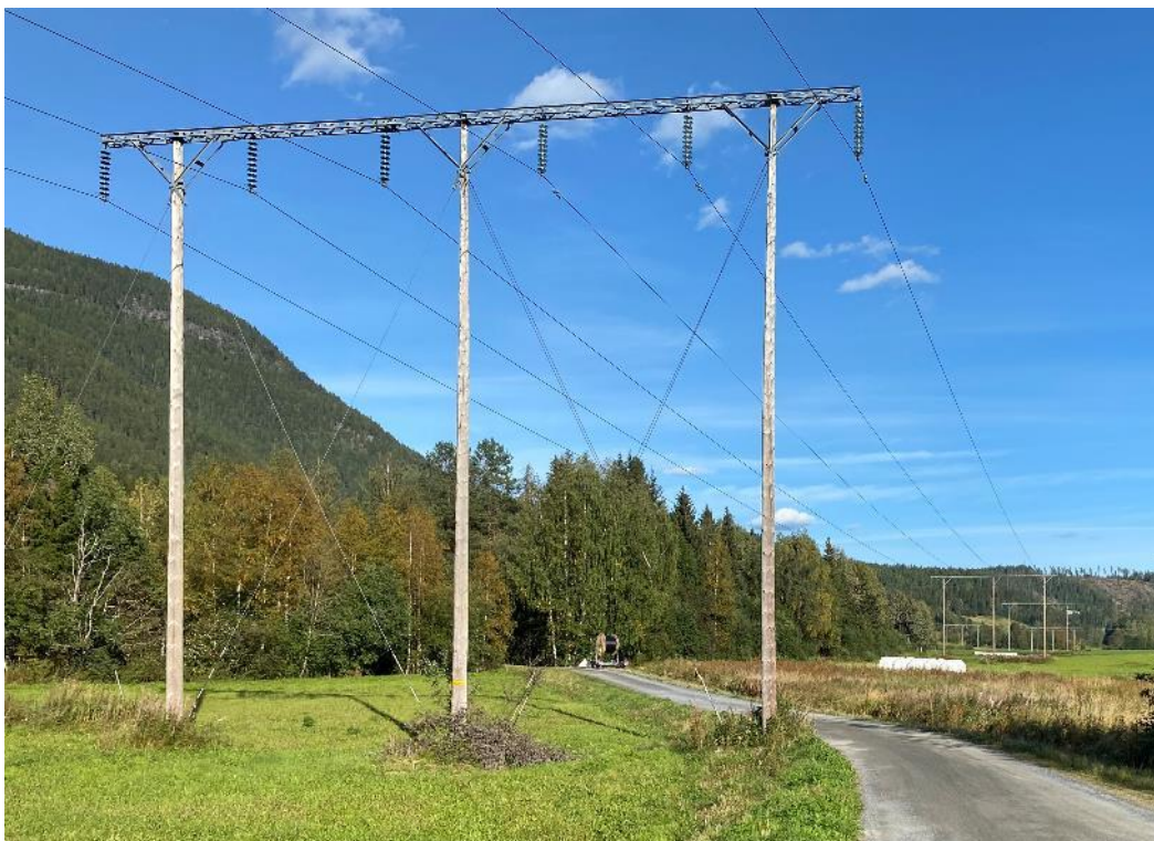
Figur 2-2 Typisk mastebilde - dagens ledning
