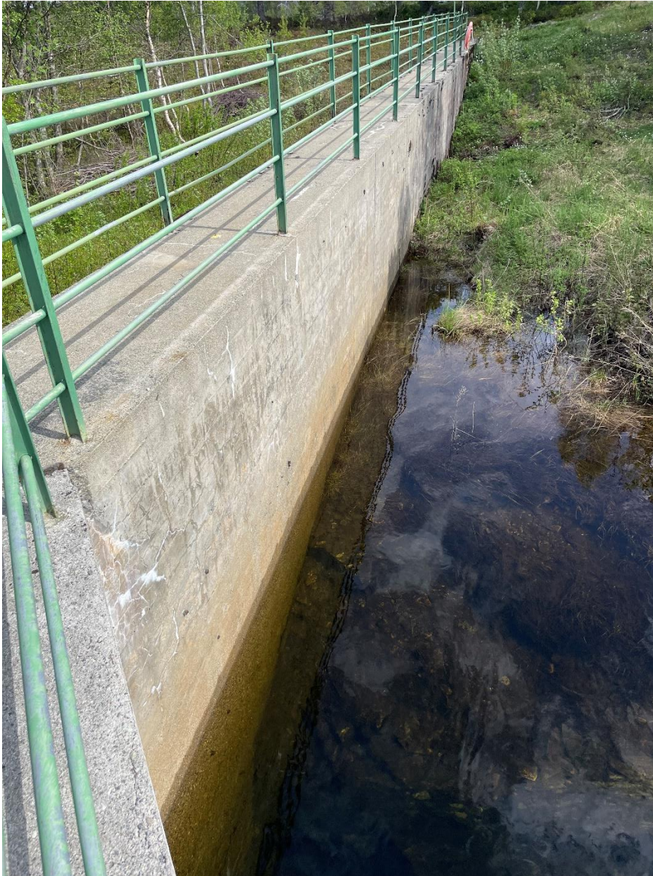
Figur 5 Oppstrøms side av østre gravitasjonsdam hvor det skal etableres påstøp og brystning. Dette området vil også brukes til deponering av overskuddsmasser.
