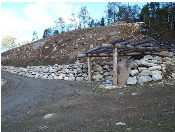
Figur 20. Opparbeidet og generelt sett lokalt forringet område ved Urdelva.
