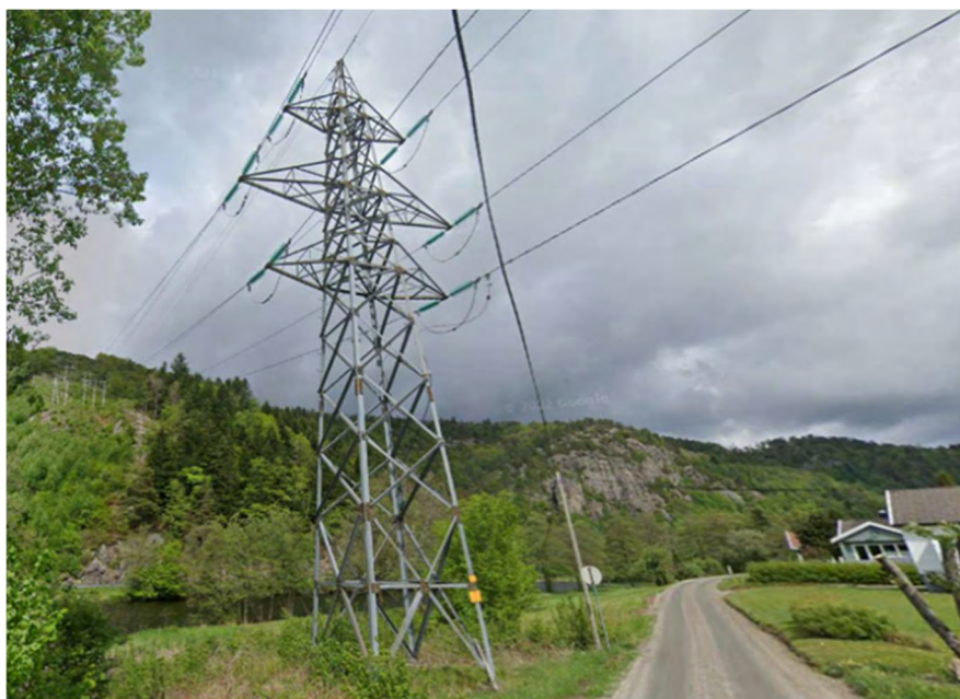
Figur 11-8: Dagens dobbeltkursmast plassert mellom elva Audna og fylkesvei 4058
