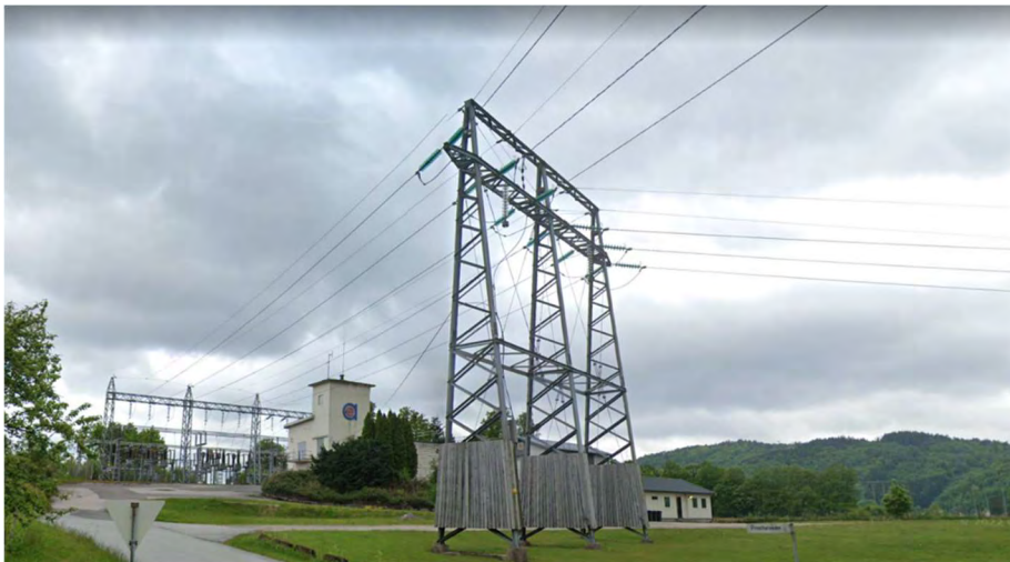
Figur 6-4: Dagens endemast (dobbelkurs midt i bildet) før innføring til innstrekkestivet i Lyngdal transformatorstasjon, som ses i bakgrunnen.
