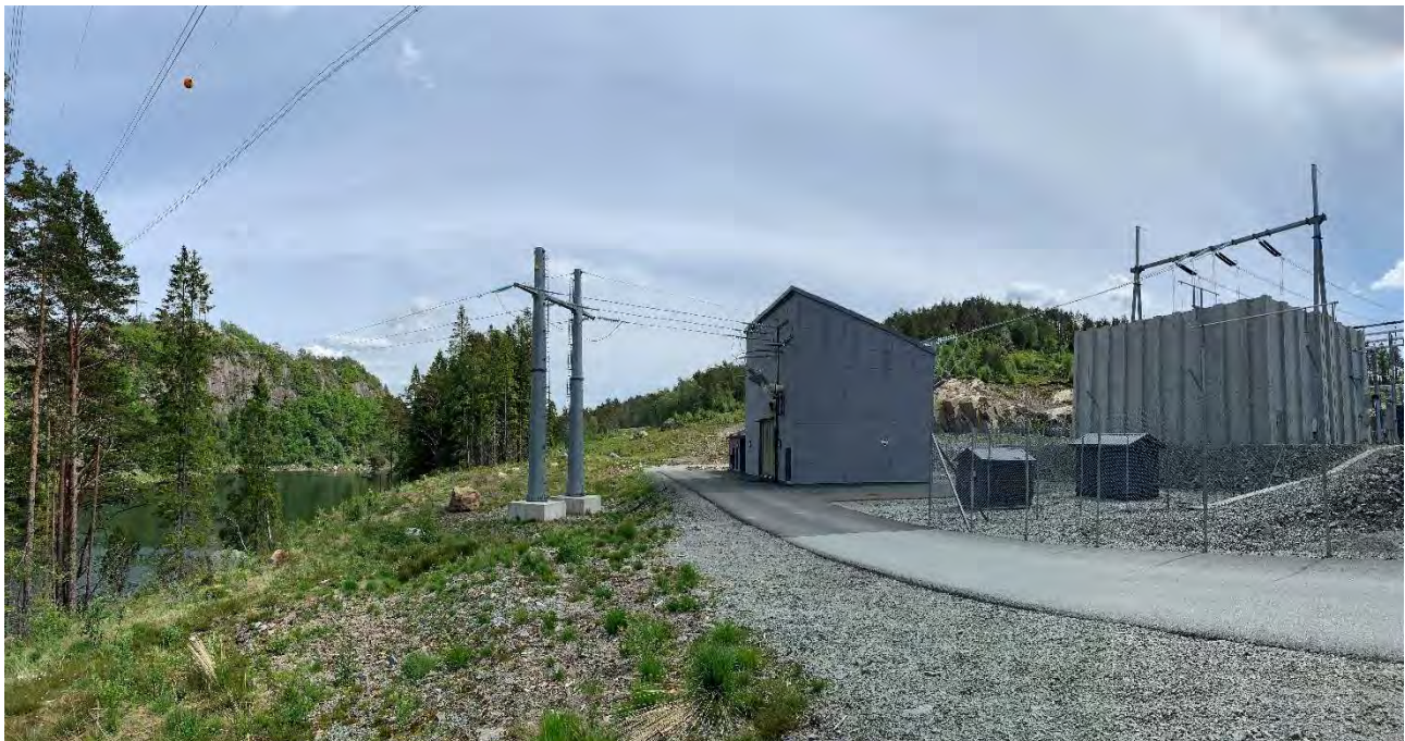
Figur 6-11. Bygget midt i bildet er Agder Energi Nett sin koblingsstasjon ved Kvinesdal transformatorstasjon.
