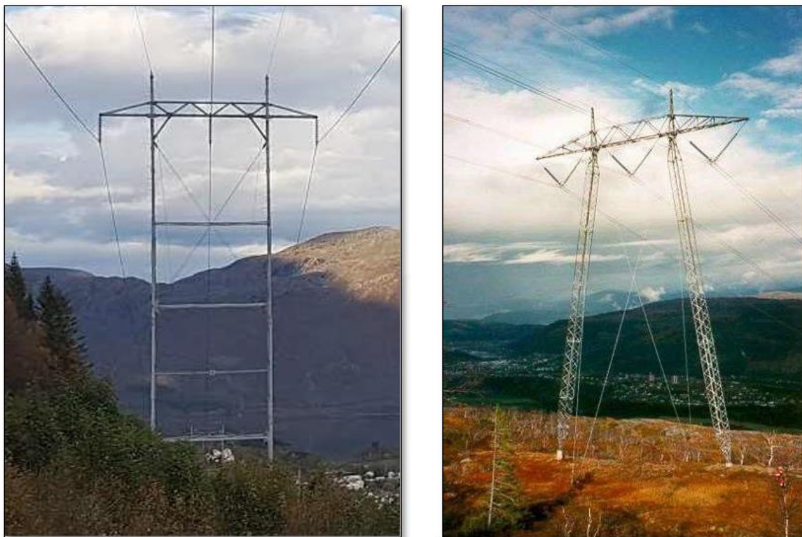
Figur 2-8. Bilder av aktuelle mastetyper, til venstre selvbærende stålmast (portalmast), høyre: innvendig bardunert mast (M-mast).
