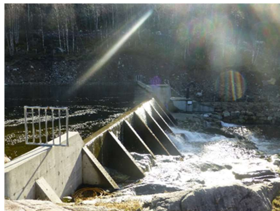
Figur 13 Inntak Nedre Neset kraftverk
