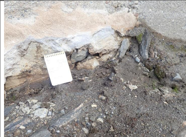
Bilde 19: Skade/ lekkasjepunkt
