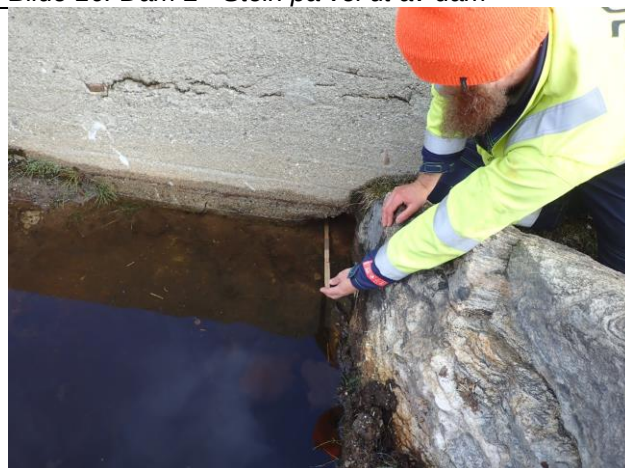
Bilde 18: Glippe/ lekkasjepunkt
