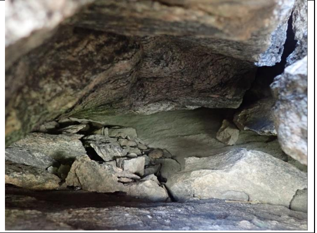
Bilde 22: Dam 2 - Store hulrom i nedstrøms mur
