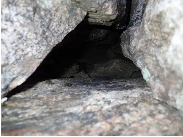
Bilde 21: Dam 2 - Store hulrom i nedstrøms mur
