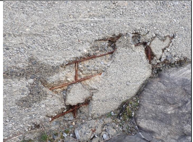
Bilde 20: Synlig armering i bunn av damplate
