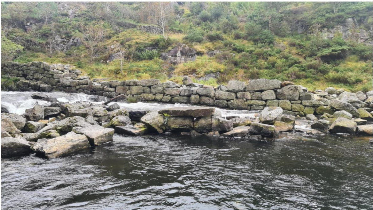
Figur 66: Utløp i sjø sett fra annen vinkel ved «høy» vannføring (dato: 07.08.2025).
