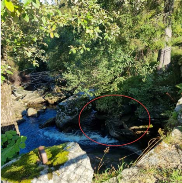
Bilde 1: Erosjon ved bru ved Øvrehagen.
