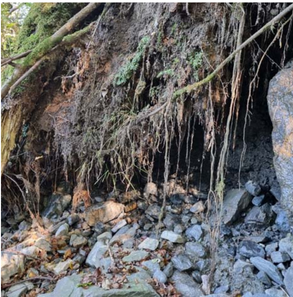
Bilde 13: Erosjonen har medført undergraving under vegetasjonsdekket på den nordøstlige delen av elven.
