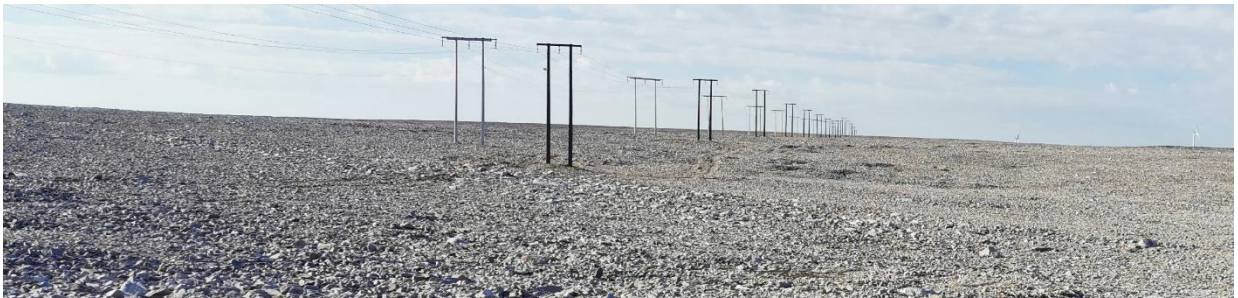
Figur 5. Eksisterende masterekket sett mot sør fra Berlevåg/Revnes mot avgreining Storvarden, gammel 66 kV til venstre og ny 22 kV til høyre. Omsøkt 132 kV planlagt på høyre side her. Foto: Ørjan W. Jenssen, Multiconsult.
