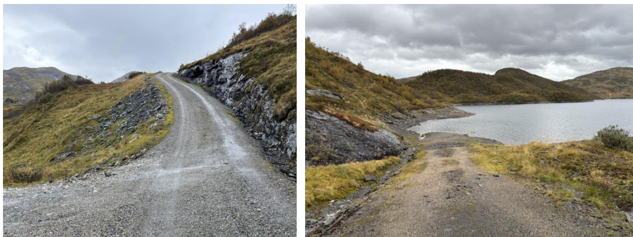
Figur 3-14: Eksisterende anleggsvei som må forbedres og utvides (venstre). Eksisterende anleggsvei mot dammen der veien ligger under HRV hvor veien er planlagt hevet (høyre).
