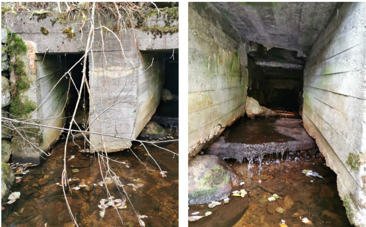
Figur 15: Utfordrende kulvert under Sønedeledveien (Foto: NIBIO, Yvonne Rognan). Slike vandringsutfordringer kan utbedres med fleksiterskler.
