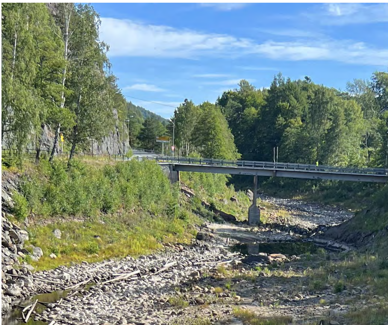
Figur 8: Bildet av bilbrua og elva 10. august 2022. Vannføringen blir borte mellom steinen i elvebunnen.
