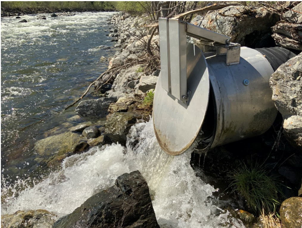
Figur A - 9 Overvannsrør som leder bekken som ligger øst for transformatorstasjonen ut i Finna. Lokalisering er vist i Figur A - 1.
