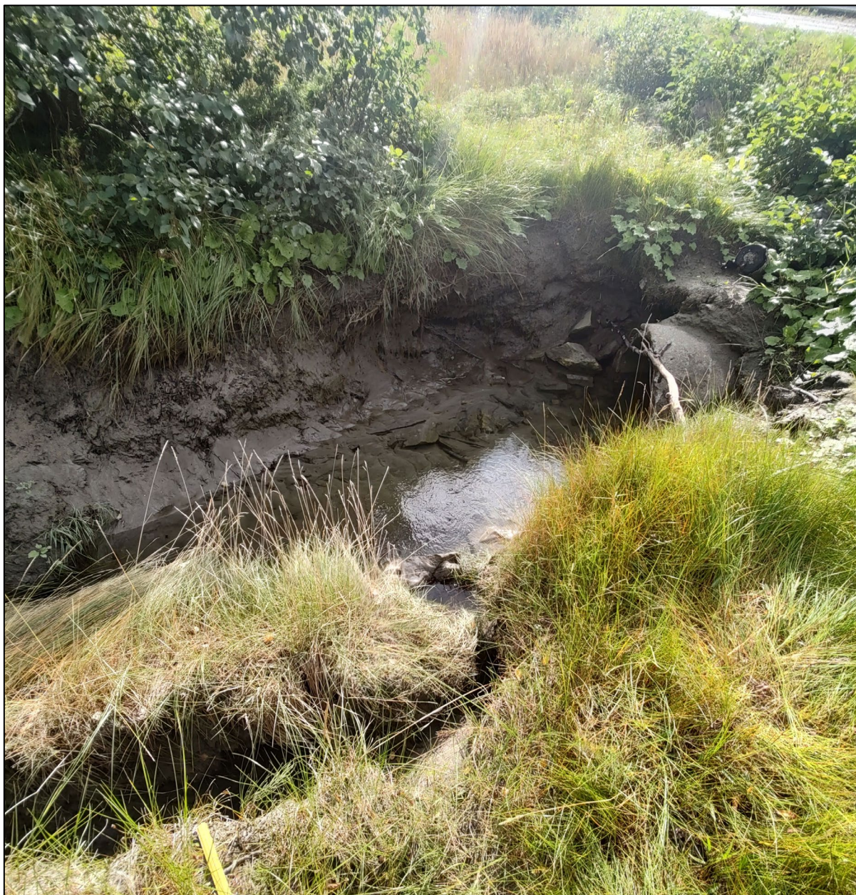
Figur 4. Erosjon/utglidning og undergraving der Dalåga renner i rør under Soløyveien.
