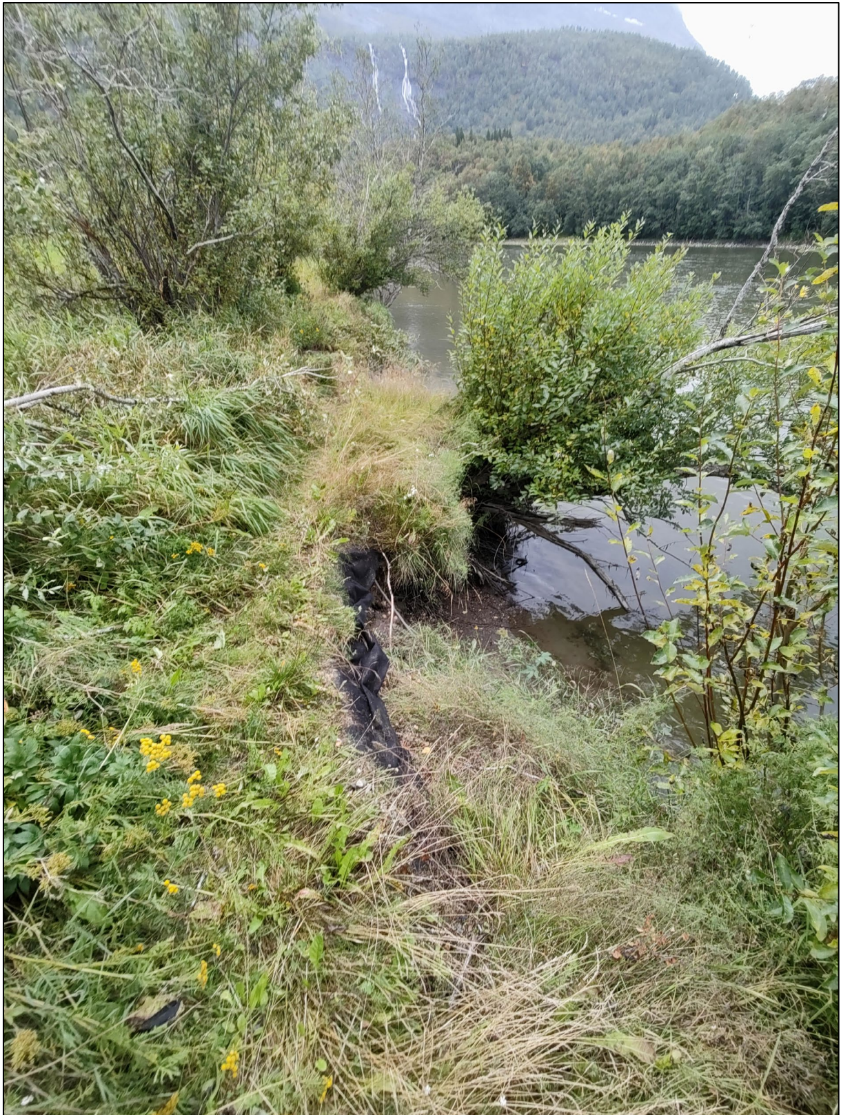
Figur 17. Undergraving under tursti langs Beiarelva. Eksponert duk og grove løsmasser med noe finstoff.
