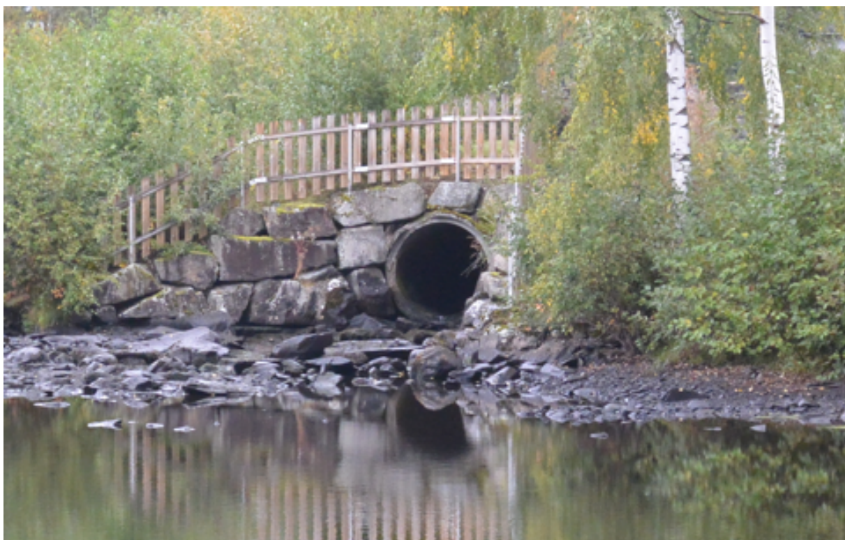
Utløp kraftstasjon uten vannføring
