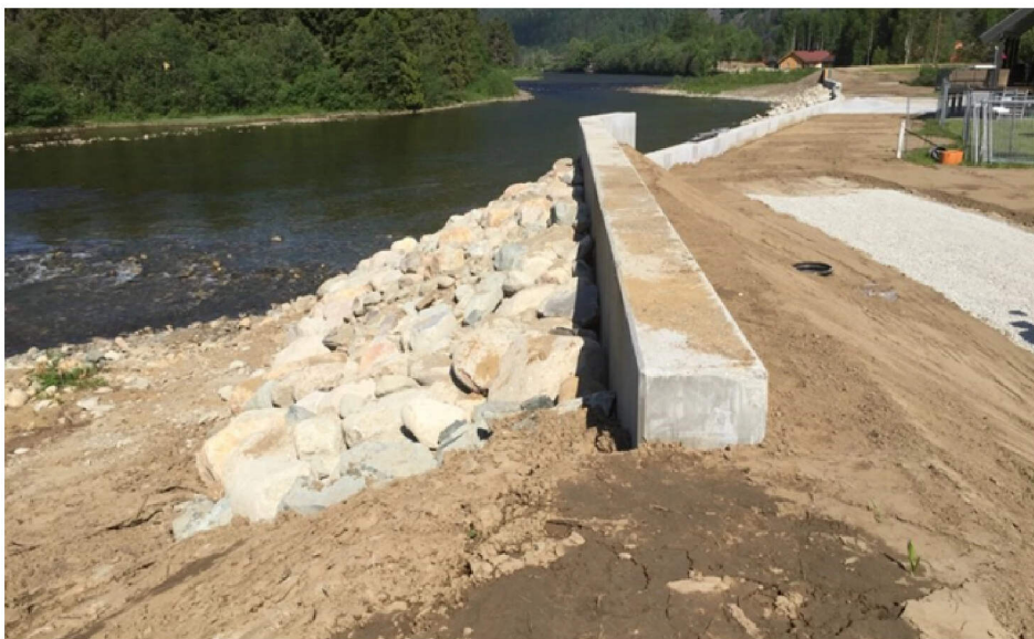
Flomvoll nr. 3 blir etablert like øst for industriområdet. (Foto: Svein A. Jerstad, NVE)
