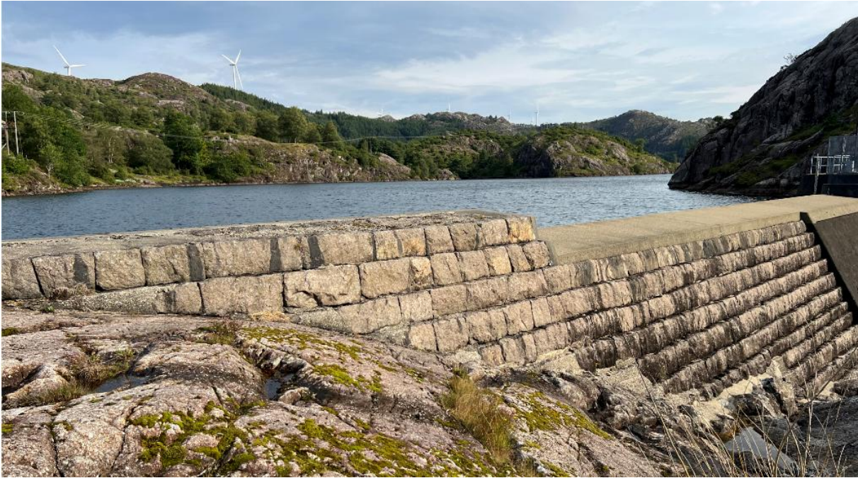
Dam Smievatn. Revurdering er utført og forsterkninger av dammen må utføres.
