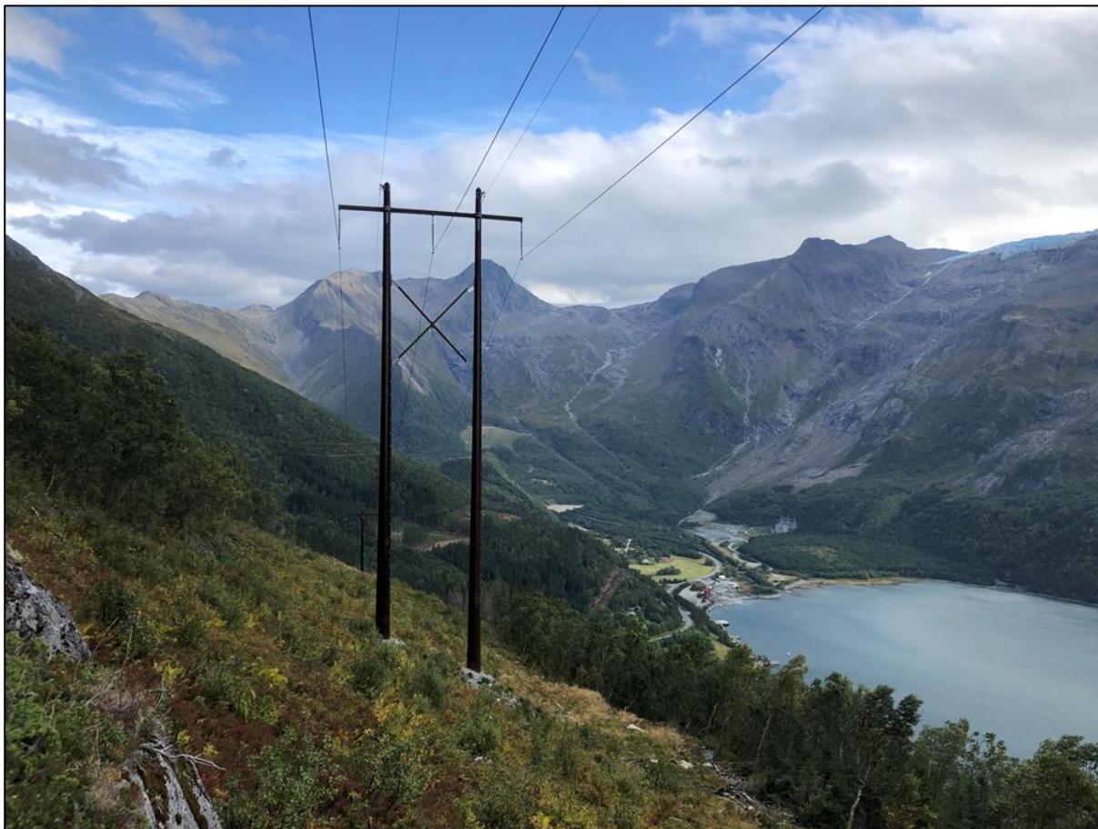
Figur 2-6: Komposittmast, her vist som H-mast med overliggende toppliner
