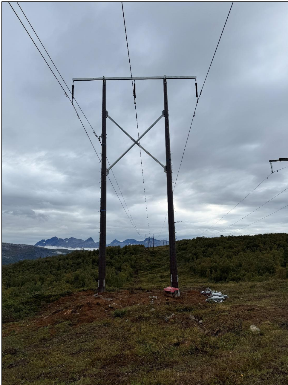
Figur 2-7: Komposittmast, her vist som H-mast med underliggende jordline og kryssavstivning
