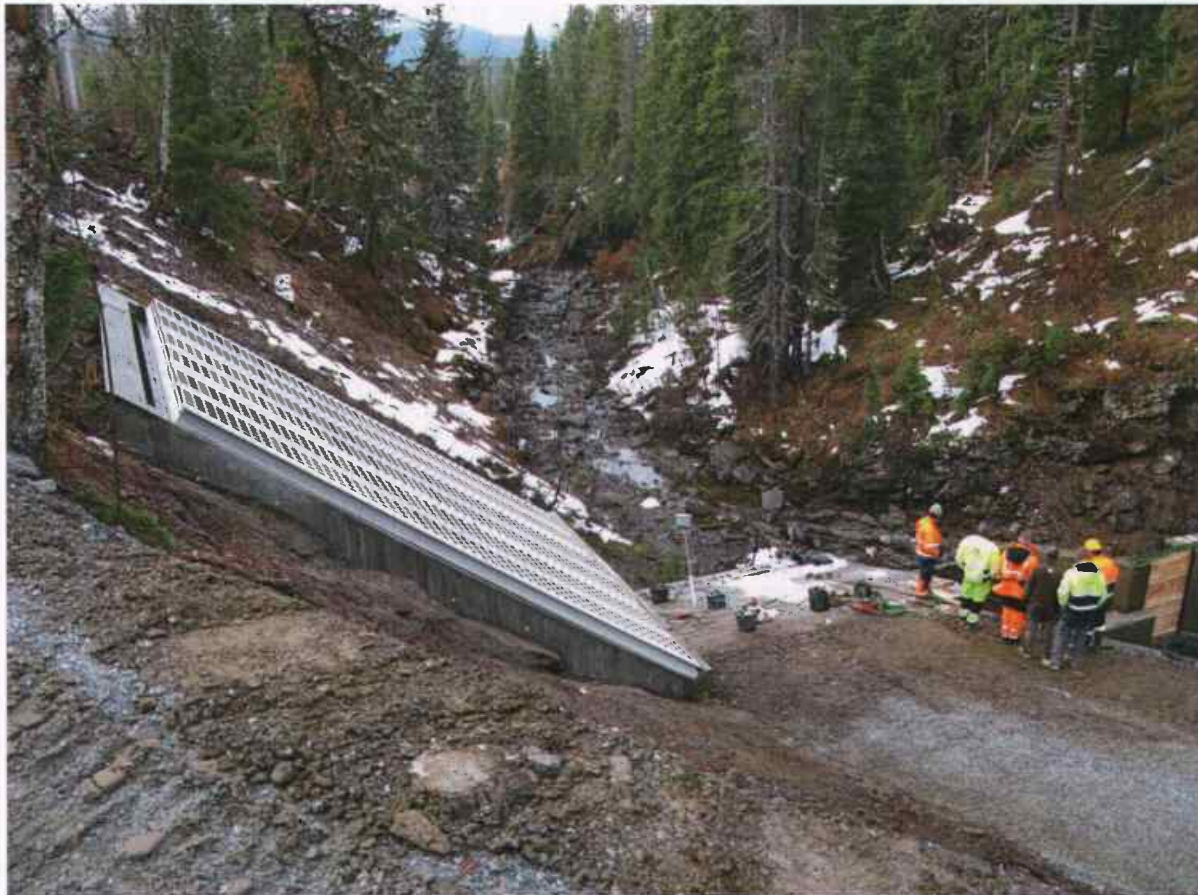
Foto 16 Sikringen av bekkeinntak. Inntakskonstruksjonen i Storbekken er sikret for mennesker og dyr.
