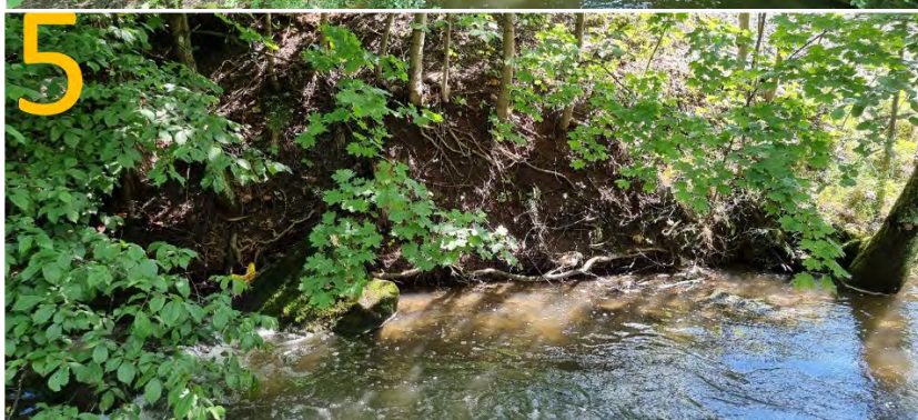
Figur 8-34. Bilder fra befaring. Øverst til venstre viser lokaliteter og retning på foto. Bilde 1 viser kvikkleireområde på Skøyen terrasse. Bilde 2 og 3 viser erosjonssikring i Hoffselva Bilde 4 og 5 viser pågående erosjon i Hoffselva
