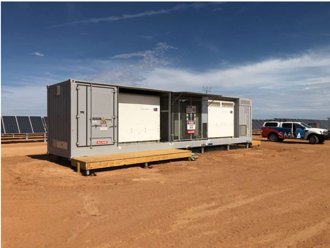
Eksempelbilde 2 av sentralinverteren, transformator og overspenningsvern
