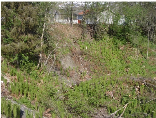
Glidning i den bratte skråningen mot bolig.
