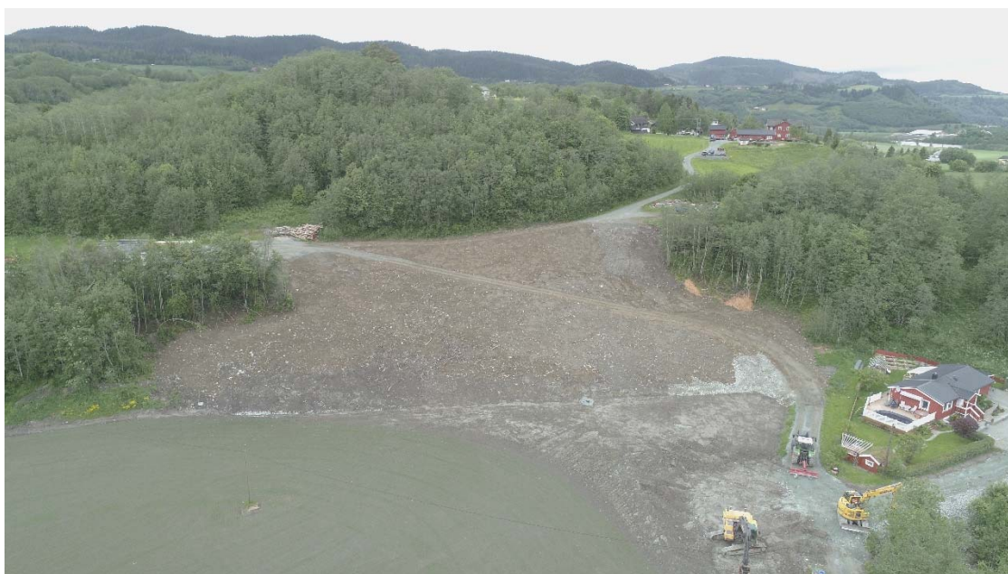
Figur 2 Etter tiltak: Dronebilde tatt av NVE 8. juni 2020. Vegetasjonsdekket er lagt tilbake over motfyllingen som er bygget opp av ca. 2 – 5 meter med sprengstein. Traktorvegen er reetablert på toppen av motfyllingen. I forgrunnen er opprinnelig dreneringsledninger lagt om.
