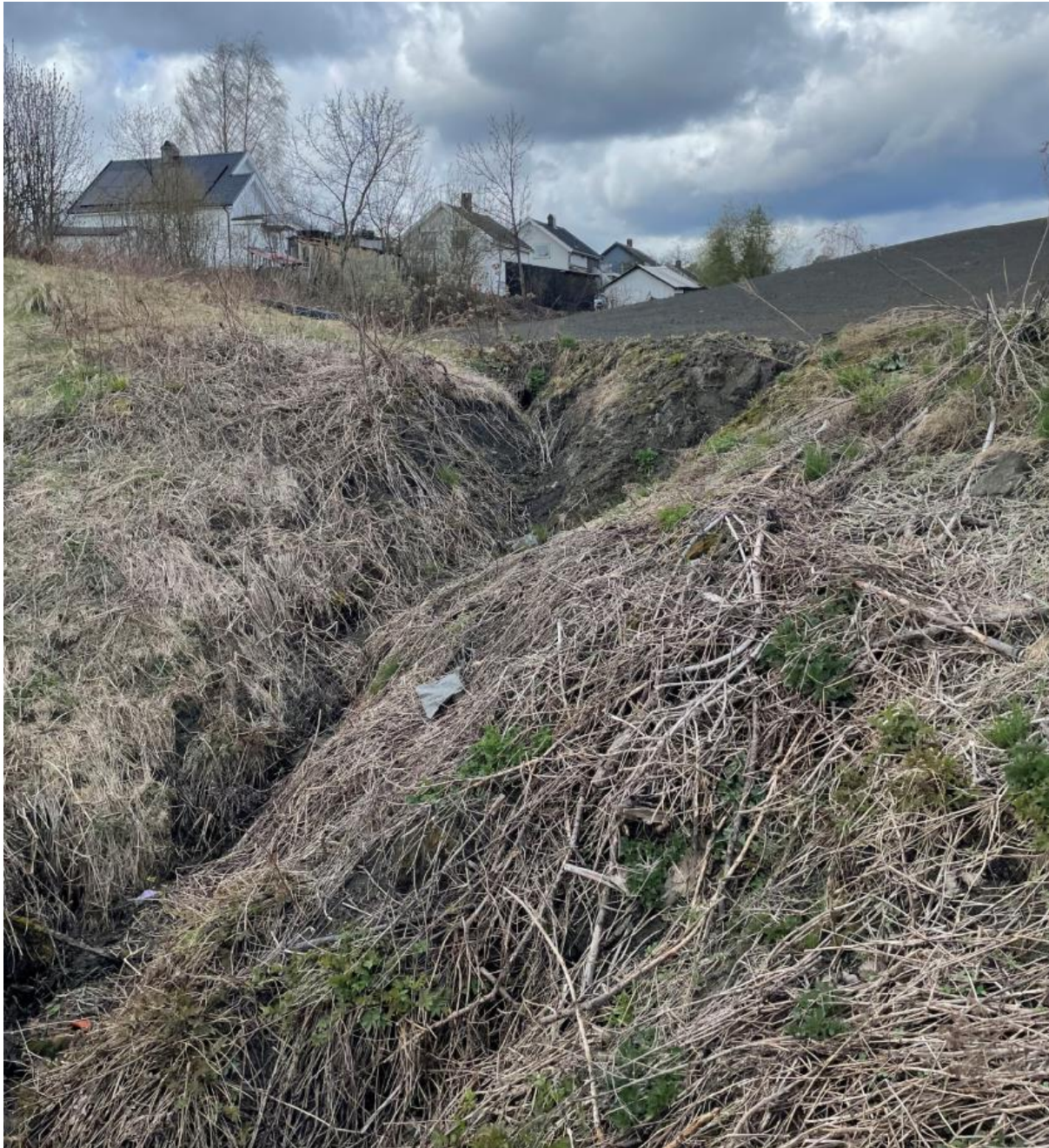
Figur 24: Bilde av Vestfosselva fra lokasjon 8 markert i figur 14. Sår i terreng, og terrenggradient som tilsier at erosjon kan oppstå.
