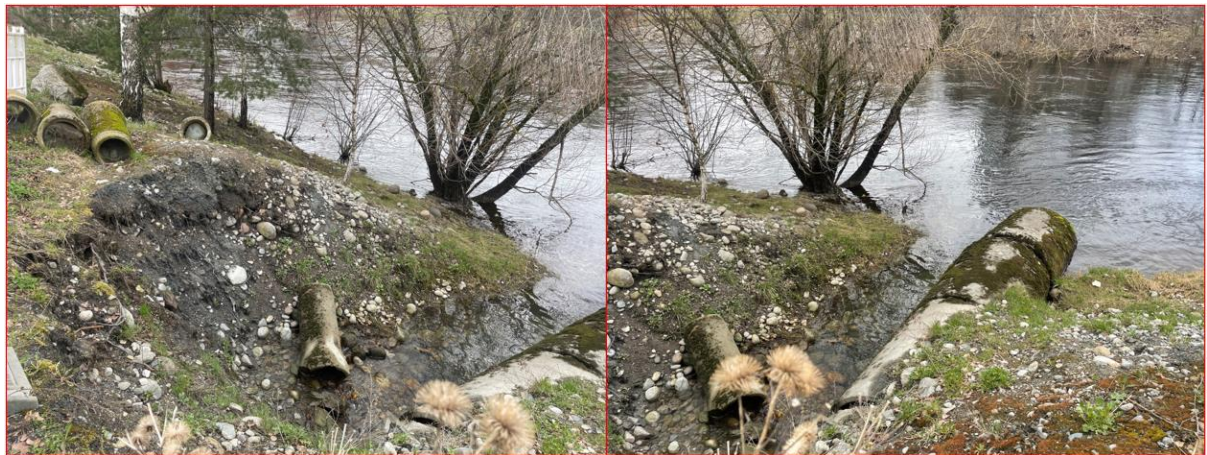
Figur 32: Rør med utløp i Vestfosselva. Lokasjon 2 på figur 30. Sår i terreng, litt erosjon.
