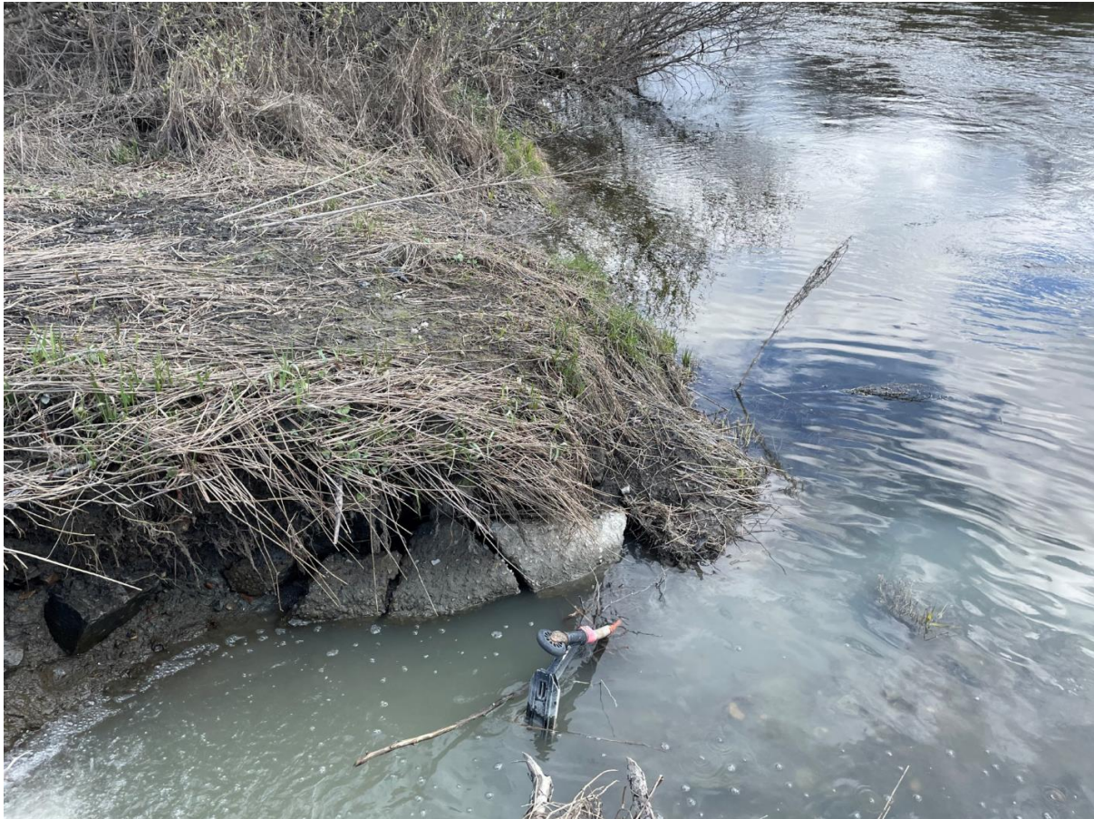
Figur 17: Bilde fra lokasjon 1 markert i figur 14. Utløp til Vestfosselva. Litt erosjon – uklart vann, sår i terreng.
