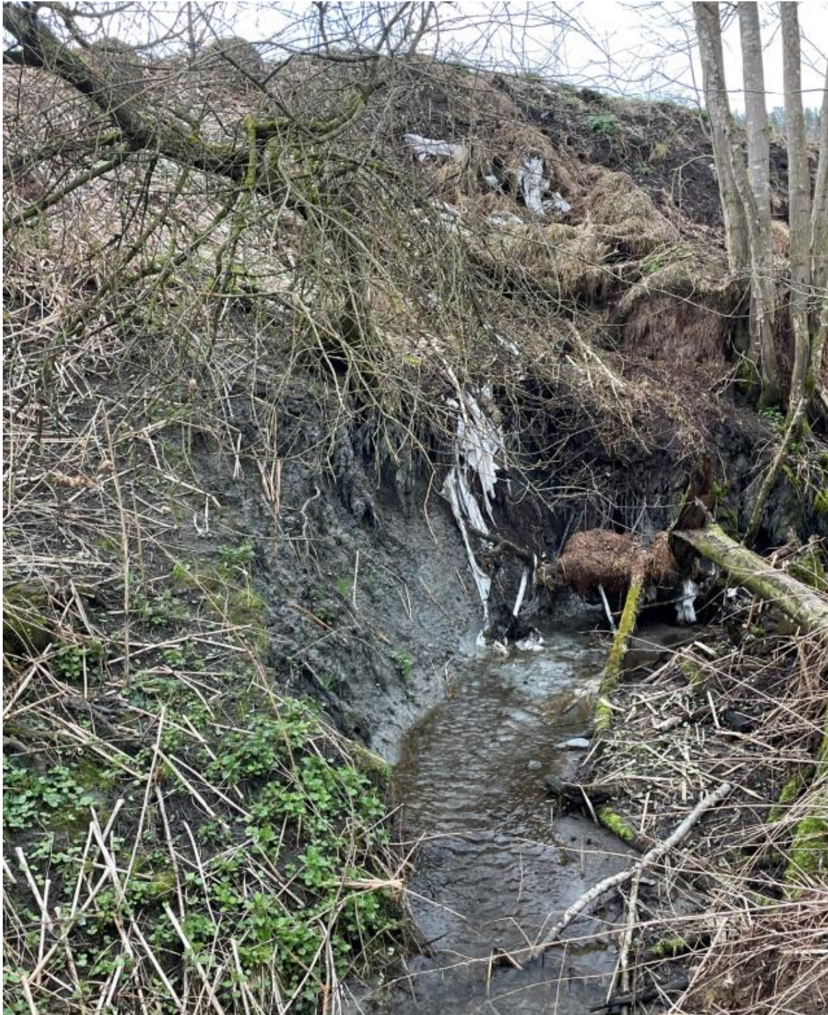
Figur 5: Bilde fra nordside av ravine ved lokasjon 3 markert i figur 1. Noe erosjon i form av overflateutglidning med eksponert silt/leire.
