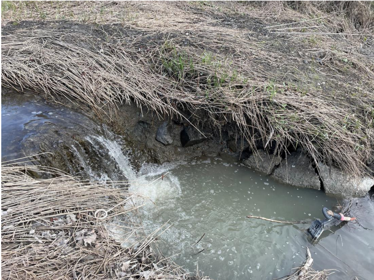
Figur 16: Bilde fra lokasjon 1 markert i figur 14. Utløp til Vestfosselva. Litt erosjon – uklart vann, sår i terrenget.
