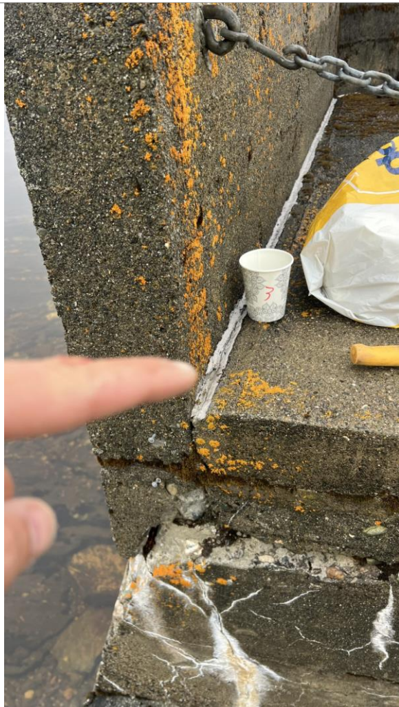
Bilde 9: Prøve F3, seksjon H, lys fugemasse
