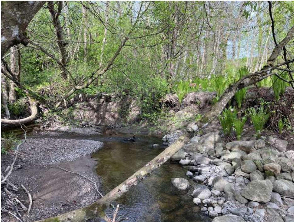
Figur 29 Punkt 19 Litt erosjon i yttersving mot sør, men begrenset av at det er flatt bak
