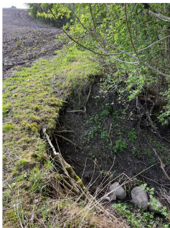
Figur 16 Punkt 13 Utglidning i topp skråning ved dreneringsløp
