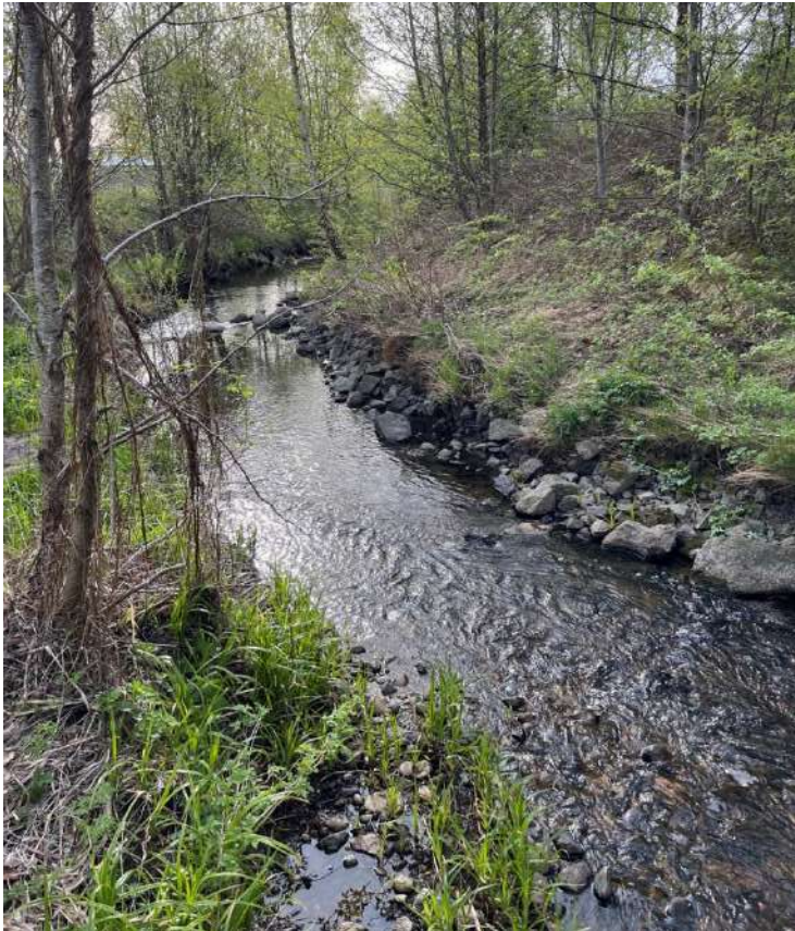
Figur 11 Punkt 9 Ser nedstrøms. Nederst mot bekken ses steinen i NVEs motfylling, men ellers bra med vegetasjon oppover i skråningen
