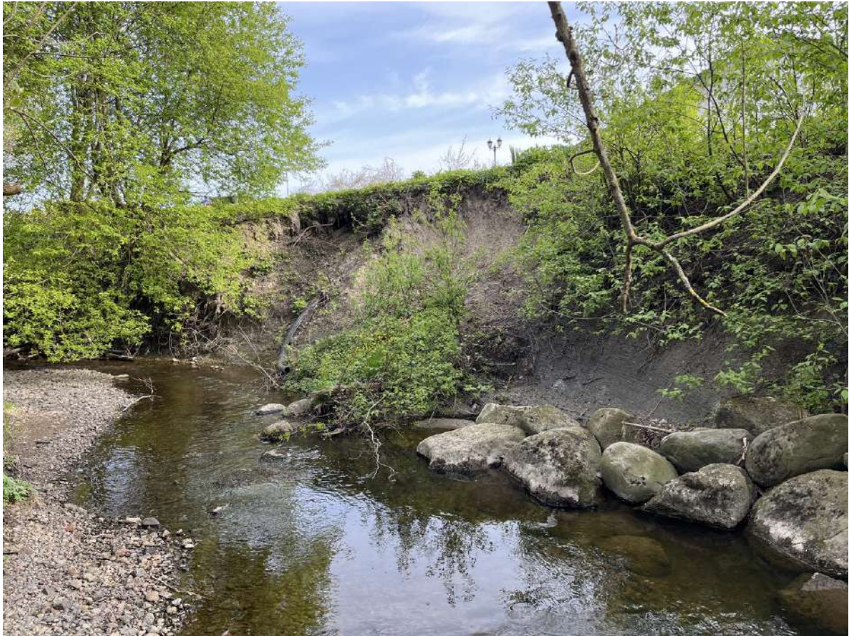
Figur 5 Punkt 3 Utglidning i yttersving. Det er lagt noe store stein i foten like nedstrøms, som kan ha forverra erosjonsforholdene i svingen. Det er også utløp av et drenerør, om kan ha medført graving
