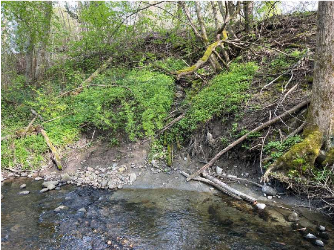
Figur 18 Punkt 15. Foto 3. mai. Noe erosjon i skråningsfot. Mye utfylte masser og søppel i skråningene mot nord, inkl. beinrester etter slakt.
