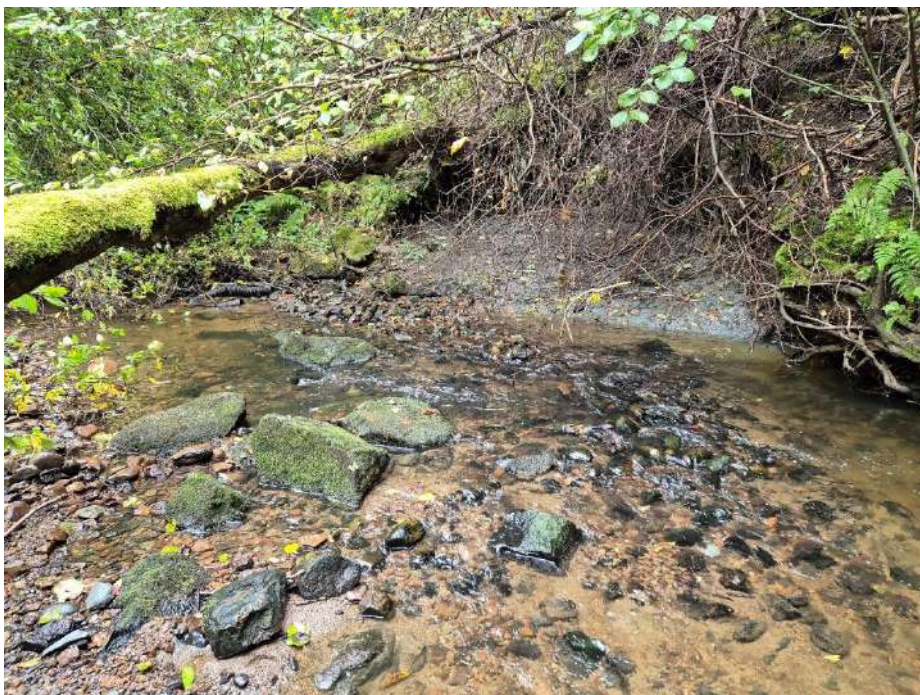
Figur 10: Litt erosjon eller mindre utglidning i leire i bunnen av skråning ved punkt A
